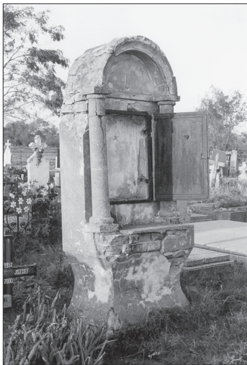
Ilyen állapotban voltak a stációk a felújítás előtt
