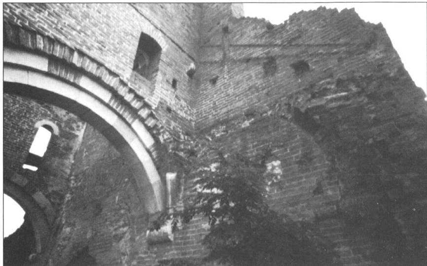
5. kép: A déli mellékhajó tetőzeteinek csatlakozási nyomai a nyugati falon
